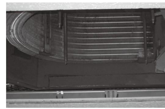
汚れがとれ、coilの金属面が確認できます。
