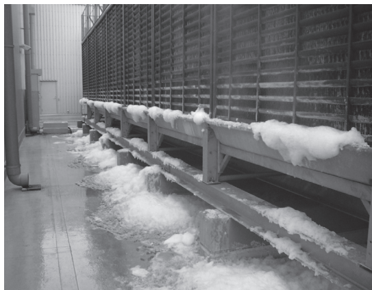
写真1 泡の発生状況
