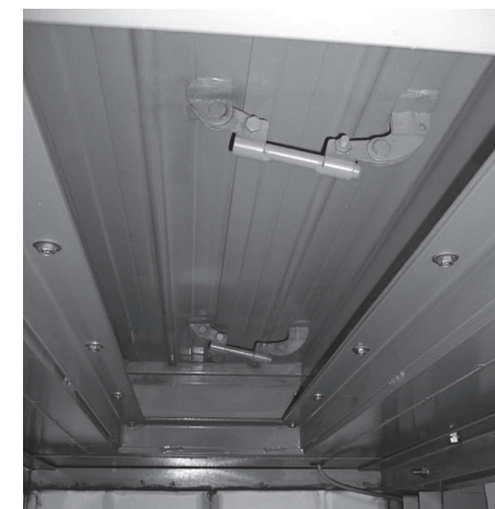
写真1 空調機内の還気ダンパ
